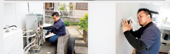
▲家庭用給湯器の法定点検
